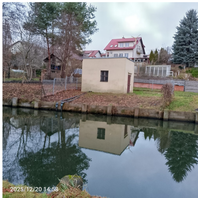
Figura 1: Widok od południa na budynek z pompą która dzień i noc pompuje wodę do pomieszczeń podziemnej poniemieckiej fabryki (jednak nie w sposób ciągły, tylko co jakiś czas się włącza aut.). Rury wchodzące z drugiej s. i wchodzące w wzgórze są nie widoczne jednak jest tam tunel który nawet po wojnie był zakończony uszkodzonym bunkrem obserwacyjnym. Ten bunkier jednak „zniknął” prawdopodobnie przed 2000r. Ponoć w widocznym kanale zimą testowano wytrzymałość niewolników w lodowatej wodzie. Bunkier służył jako poczekalnia dla niewolników zanim SS-mani przegonią Niemców z terenów zielonych tego osiedla (nawet po wojnie było tam kąpielisko). Widoczny budynek z pompą znajduje się w bezpośrednim sąsiedztwie starej elektrowni (z 1921r.), „Faktorii” i stawów w Pruszczu Gd., woj. Pomorskie, Polska, EU:
